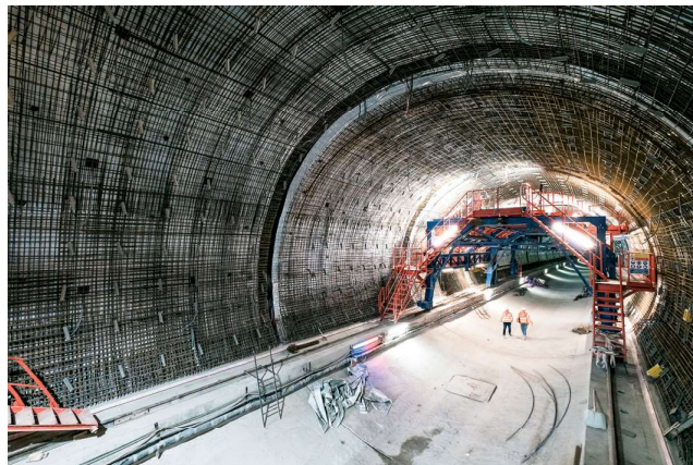
Als Konstrukteurin unterstützt Sandy Göpel mittlerweile die beiden Geschäftsbereiche Tunnel- und Wasserbau.
